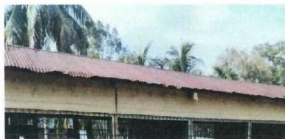
Foto 2: En esta fotografía del módulo 1 se observa el mal estado de las laminas.
