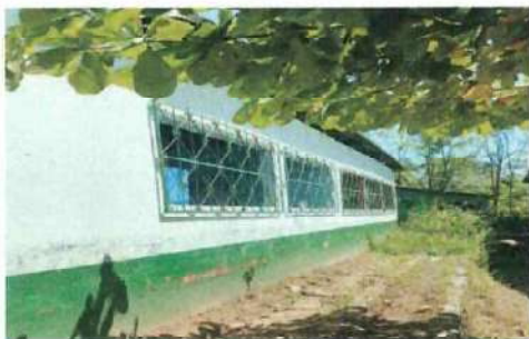
Foto 3: Deterioro de Pintura en las paredes del módulo 2.
