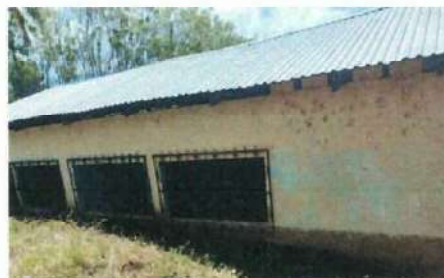
Foto 4: Deterioro de Pintura en las paredes del módulo 2.
