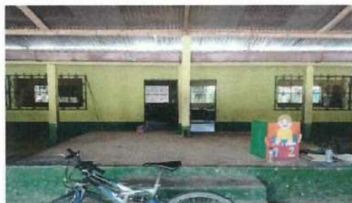
Foto 5: Deterioro de Pintura en las paredes módulo 2.
