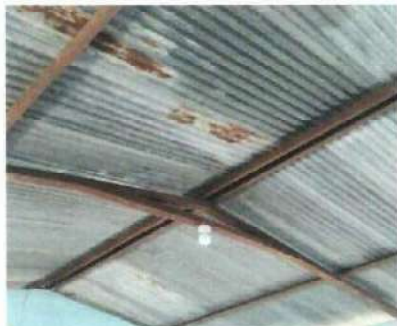
Foto1: En esta fotografía de módulo 1 se observa el deterioro de las costaneras.
